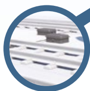
Kabel für Weichenantriebe
