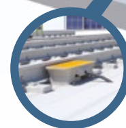
Kabel für Achszähler
